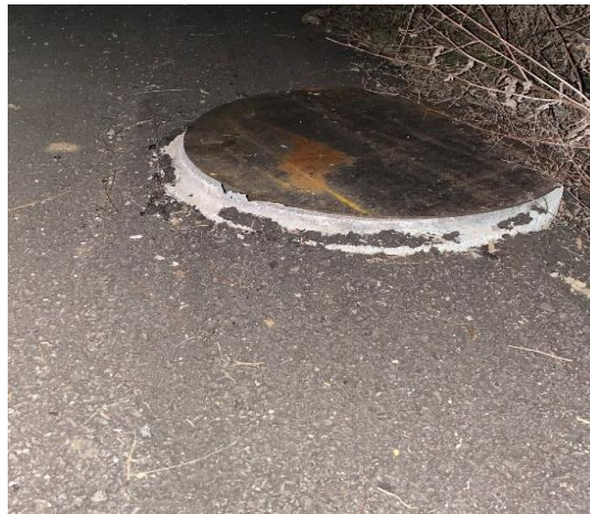
Fotografia 25. Puseta me material metal
